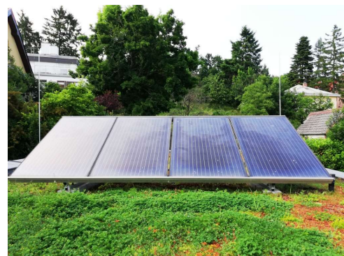
Solarwärme und Dachbegrünung (Quelle: Alexander Friedrich)
