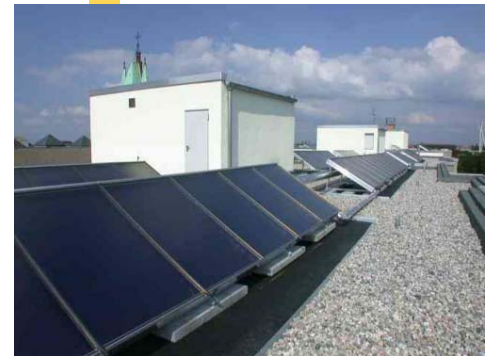
Berlin: Umsetzung eines 164 m 2 großen Kollektorfeldes zur Warmwasserbereitung im Zuge einer Wohnhaussanierung
