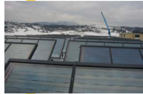
Die ersten 500 m 2 der 2600 m 2 großen Solaranlage wurden bereits installiert und in Betrieb genommen.
