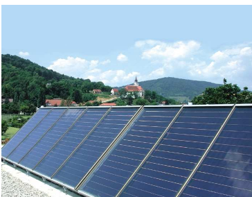
30 m 2 Kollektorfläche am 6 Wohnungen umfassenden Projekt in der Grazer Nittnergasse
